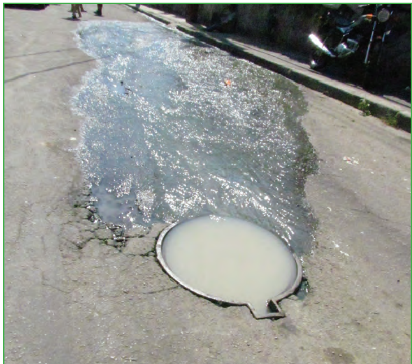
Esgotos abertos podem espalhar doenças de transmissão fecal-oral. Evite o contato com vazamentos provindos de bueiros.
