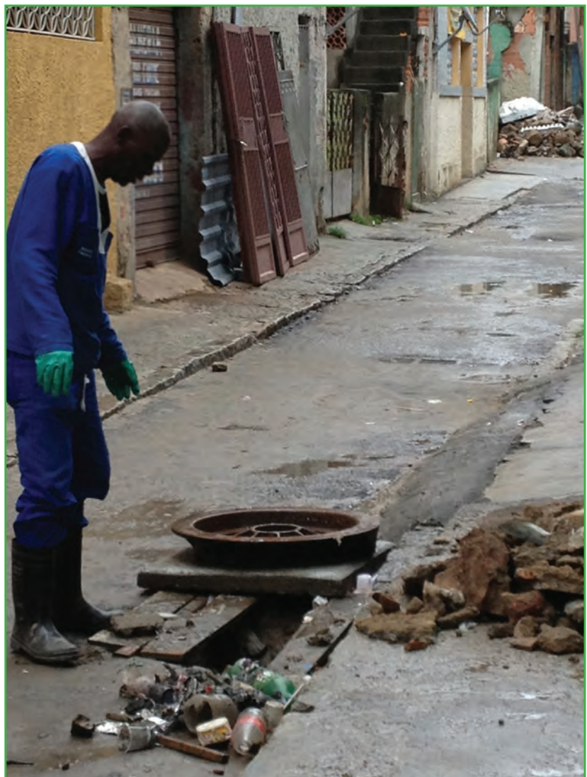
Um homem remove o lixo de um sistema de esgoto entupido.
